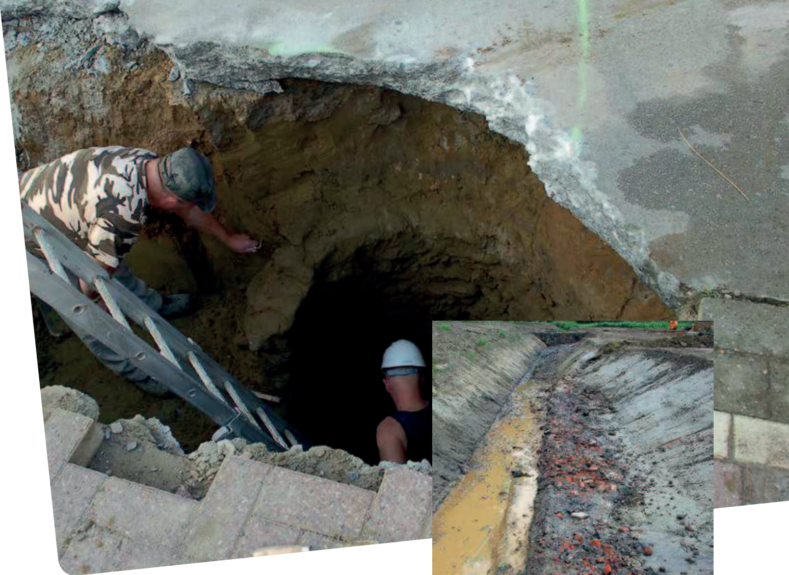
De opgebroken Rillaarseweg met de holte ontstaan door de wegspoeling van de bodem
