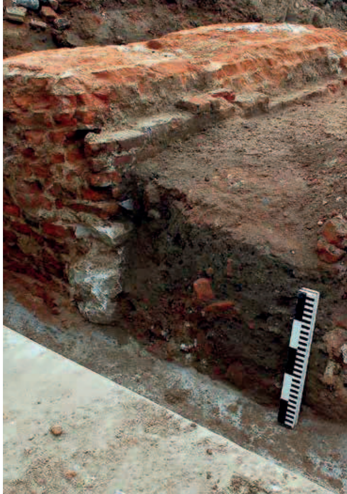
Doorsnede van diezelfde muur met de aangrenzende ophogingslaag en restanten van de fundering van het recent afgebroken klooster
