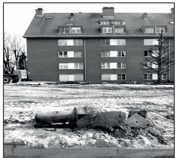
La borne 3 durant les travaux de 2018. On en voit bien la partie inférieure (cliché PA février 2018).
