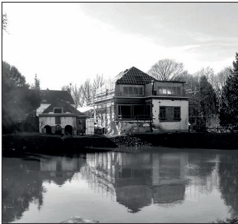
Vue du chantier du Moulin Blanc en février 2021. A l'avant, l'étang, et, à l'arrière, l'ancienne habitation en pleine transformation. Photo EdC.
