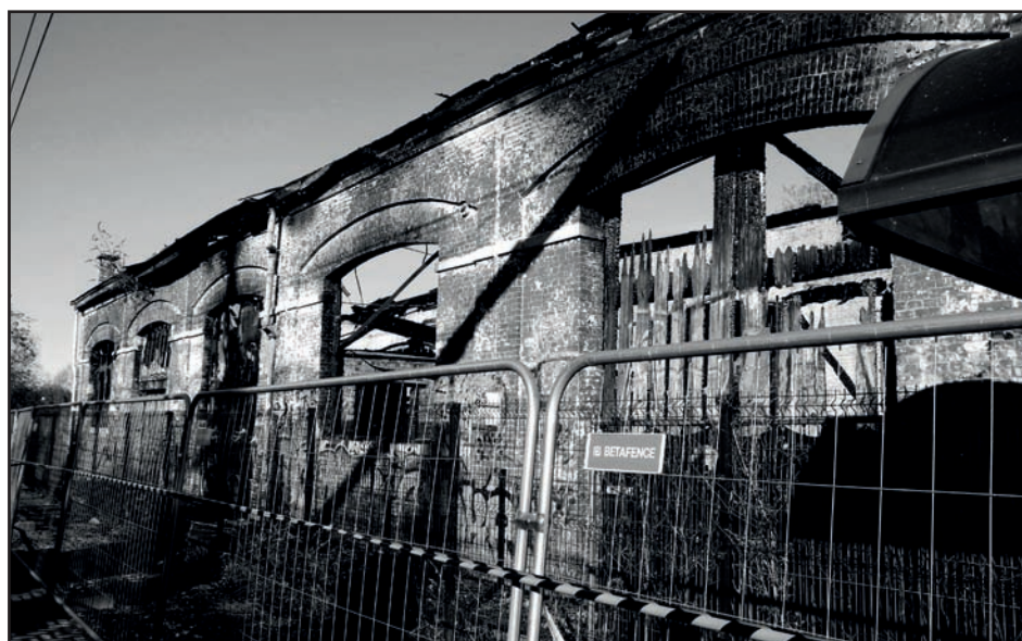
Le bâtiment après l'incendie. Photo EdC
