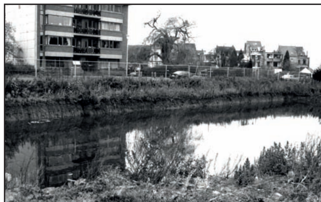
Rue du Melkriek : fondations inondées lors d'un chantier (Georges Mignon Promotion) qui a dû être abandonné, puis repris par un autre entrepreneur qui a adopté une autre technique. Photo auteur.
