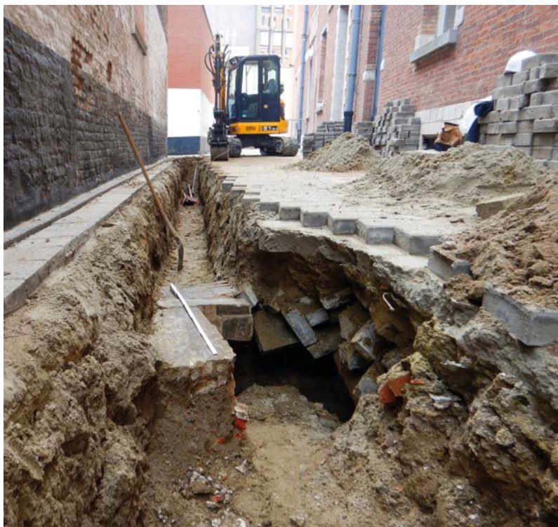
In de aanleg sleuf voor de riolering werd de bovenzijde van een waterput aangesneden.
